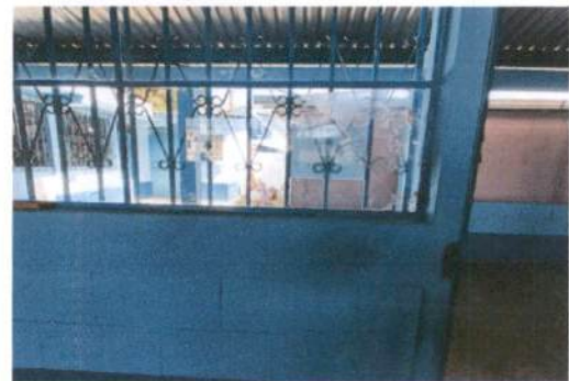
Foto 12: Sustrucción de vidrio.
